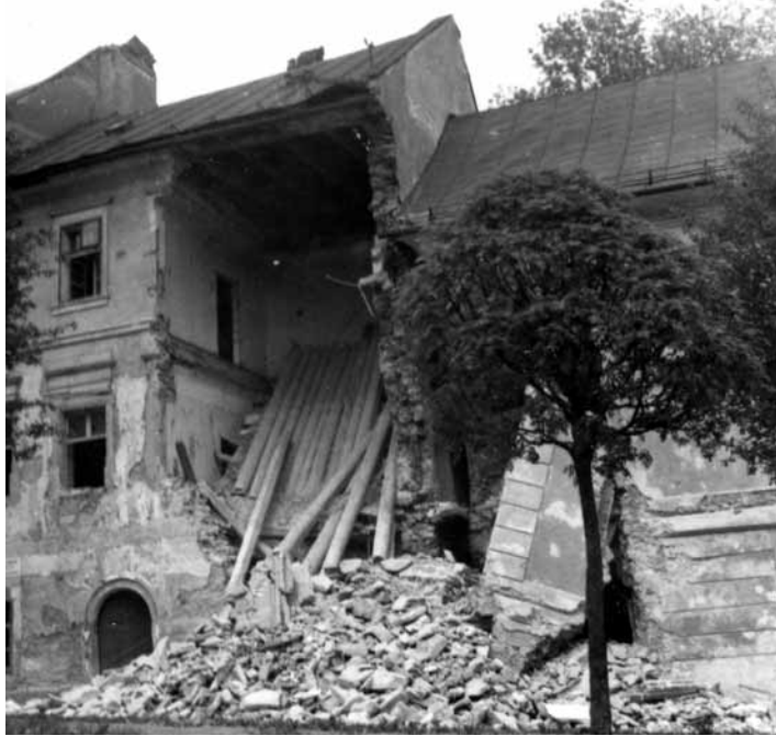
Havarijný stav meštianskych domov - Richterov a Jonášov dom, rok 1969 FOTO ARCHÍV SBM
