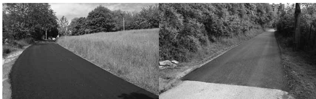
Nový asfaltový povrch na ul. Údolná a ul. J. Fándlyho FOTO MICHAL KRÍŽ
